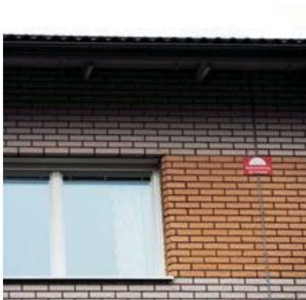
Tips: Om byggnaden har brandsektionerad vind är det en bra idé att ha skyltar med texten "Sektionering på vinden" uppsatta på fasaden där sektioneringarna finns. Då ser räddningstjänsten direkt var de är.
