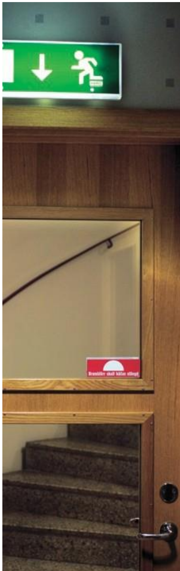
När det brinner får det inte uppstå tveksamheter kring var man kan ta sig ut. Utrymningsvägar måste vara tydligt markerade.
