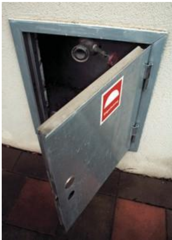
I stigarledningen i luckan på fasaden kan räddningstjänsten koppla in vatten. Inne i trapphuset finns sedan uttag där slangar kan anslutas.
