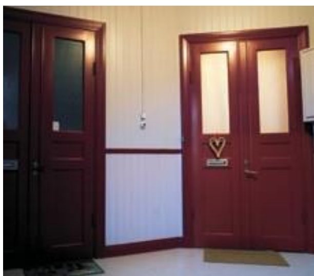
Gamla spegeldörrar är vackra men ger inget bra brandskydd. Skyddet kan dock förbättras genom att man förstärker dörrarna på insidan.
