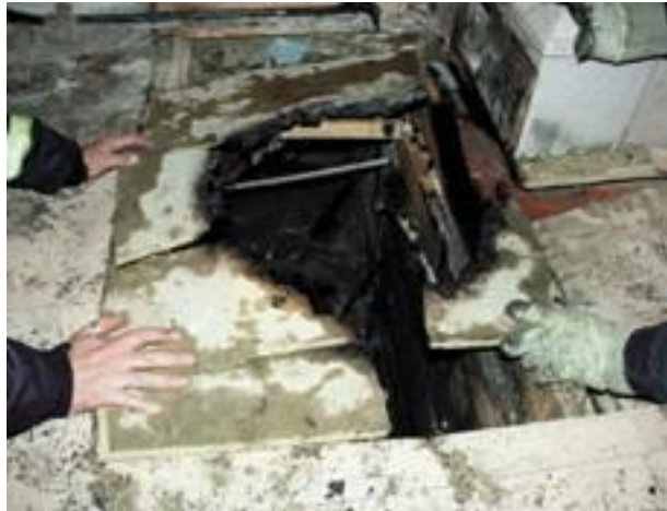
Felaktigt hanterad aska är en vanlig brandsorsak. Här har golvet brunnit när aska från en kakelugn som det eldats i dagen före ställts i en plastpåse på golvet.
