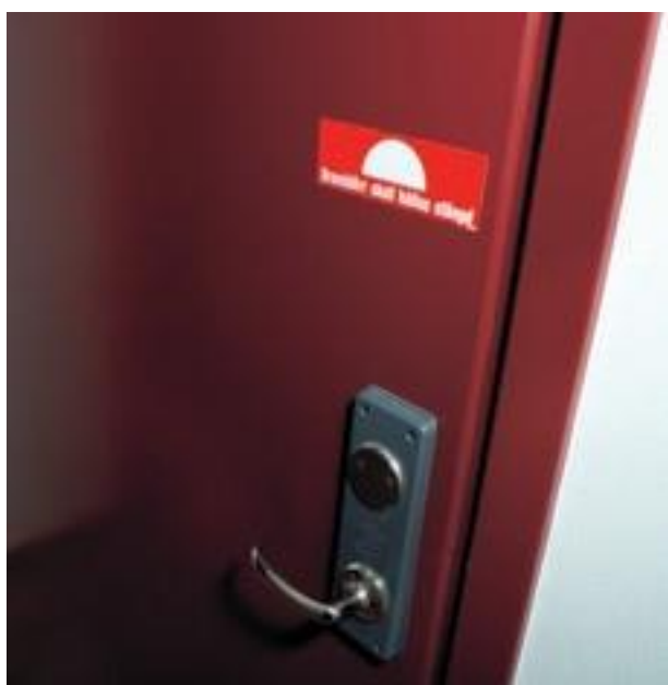
Det är mycket viktigt att branddörrar hålls stängda. De får inte ställas upp med kilar eller dylikt.
