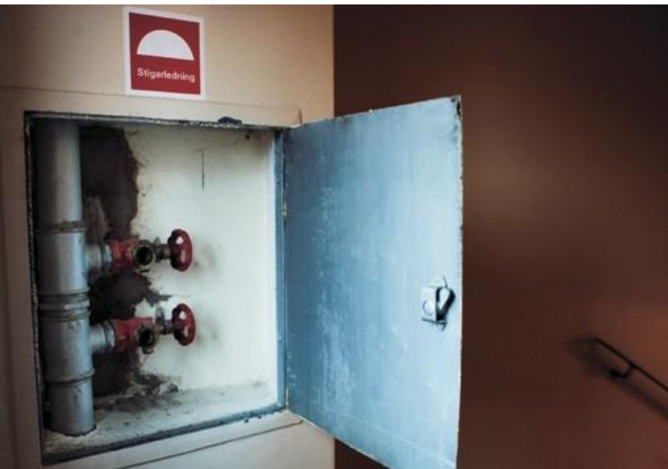
Via stigarledningen i trapphuset får räddningstjänsten vattenförsörjning utan att behöva dra slangar hela vägen från bottenvåningen.
